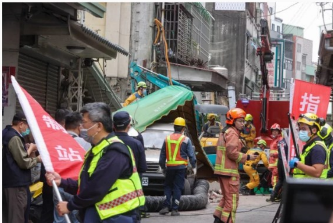
台中台灣大道一段有間老屋已拆除，昨挖地基工程，隔壁老屋往空地倒下，造成3名工人受困。記者黃仲裕／攝影
